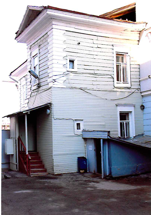
Видовая точка № 4. Восточный фасад здания. Вид со двора. Автор снимка: Однокопылова О.А., дата снимка: 08.04.2016 г.
