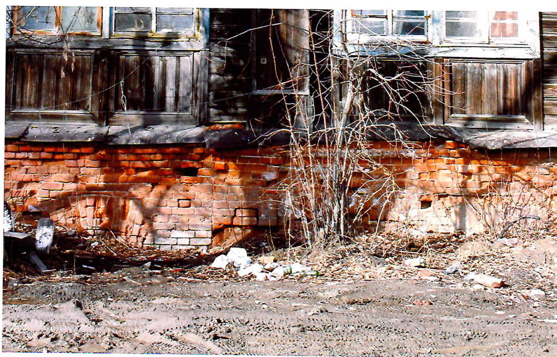
Видовая точка № 4. Фрагмент цоколя с заложенными окнами подвала. Южный фасад здания. Автор снимка: Лоскутова, дата снимка: 26.03.2012 г.
